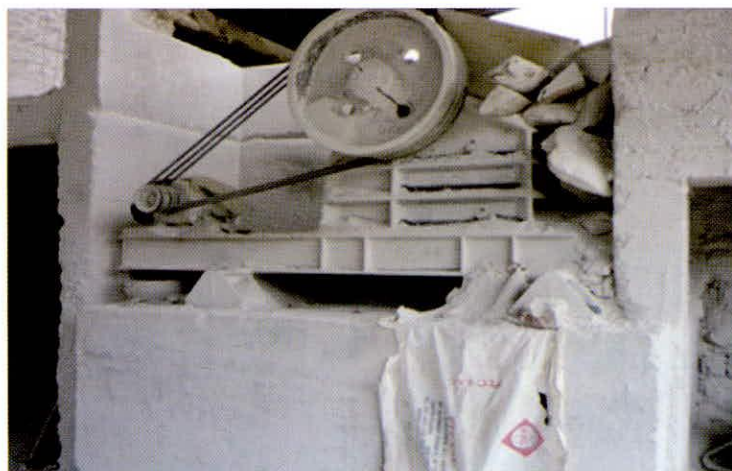
Figura 4. Equipo para trituración de piedra.
