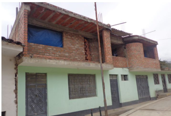
Figura 5. Mampostería con ladrillo artesanal, mortero de espesor no constante
