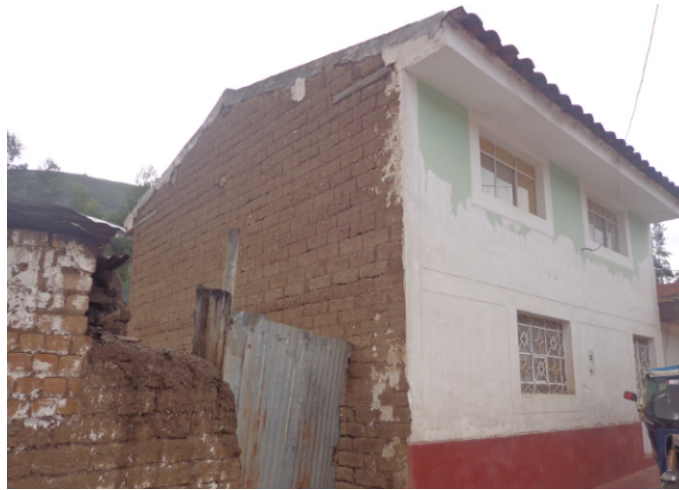
Figura 4. Vivienda que no presenta vigas y columnas de amarre
