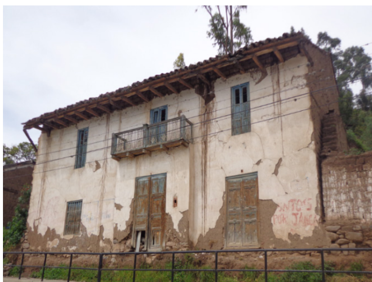
Figura 3. Vivienda de adobe en desuso
